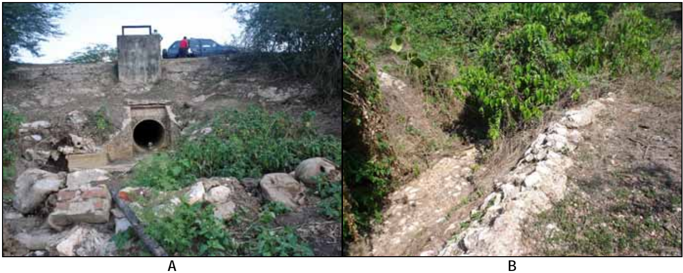
Figura 26: Estructuras para el canal interceptor de los arroyos. A) Alcantarilla de \varnothing = 0,90 metros bajo el terraplén carreteable interceptor. B) Canal aguas abajo de la alcantarillado que conduce el agua al Distrito de Riego de Danta Lucía. Fuente: CI, 2007.
