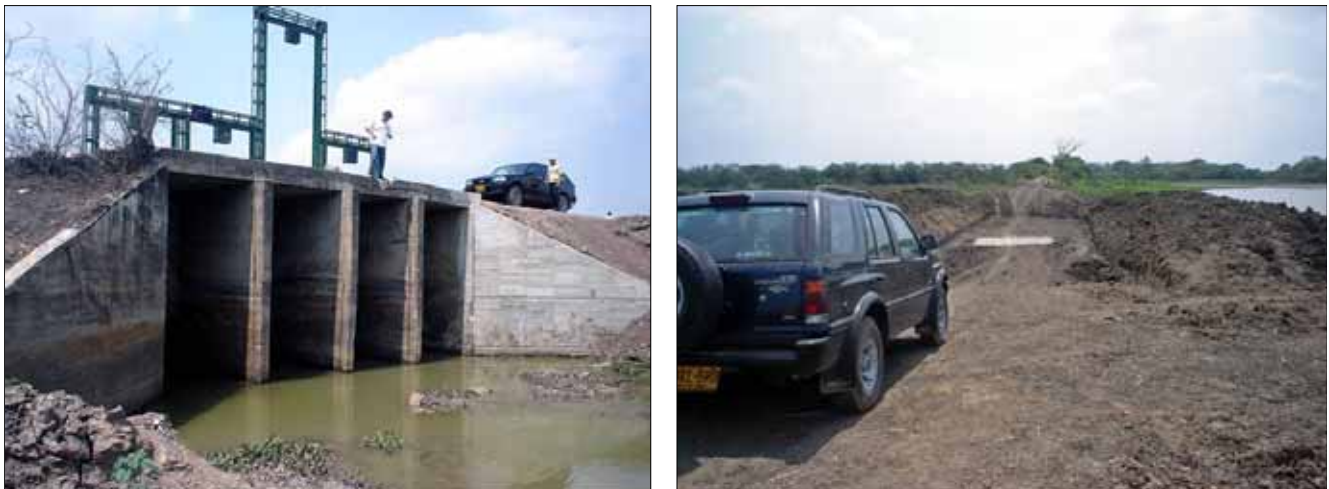
Figura 43: Compuerta y estructura en construcción en la ciénaga El Paraíso. Fuente: CI, 2007
