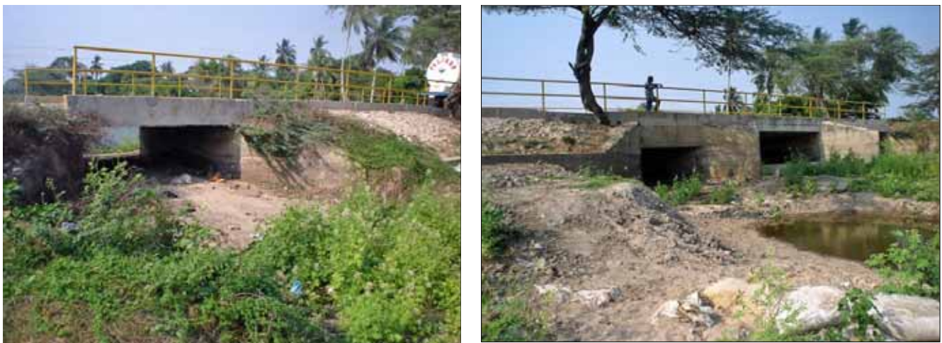
Figura 49: Estructura hidráulica que sirve al arroyo Pinguillo. Fuente: CI, 2007
