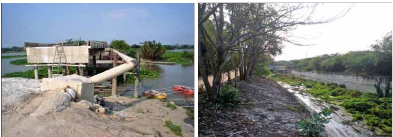
Figura 53: Puente en construcción en Caño Hondo y canalización del arroyo Caracolí. Fuente: CI, 2007
