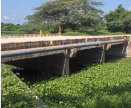
Colmatacion de canales
