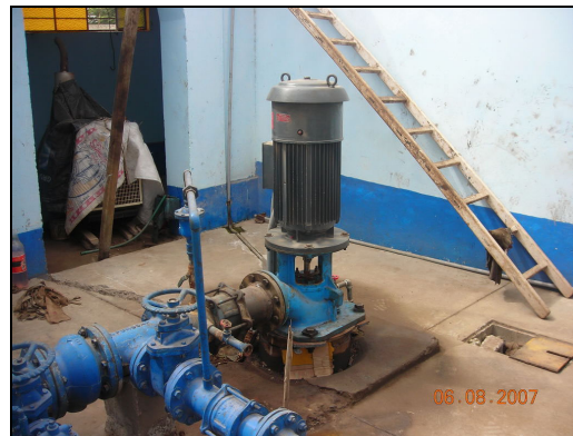
Vista N° 26 Equipamiento del Pozo N° 1
