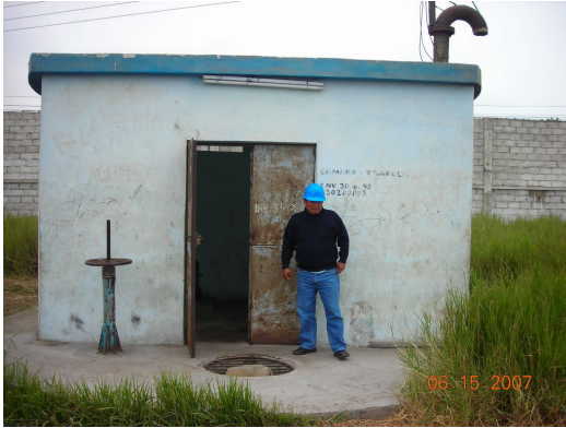
Vista N° 11.- Cámara de Bombeo de desagües Trapecio
