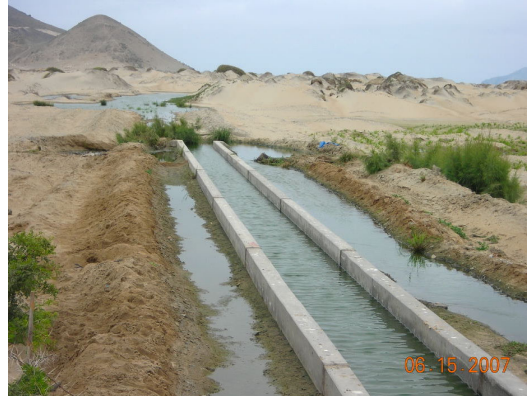
Vista N° 22.- Canal de efluentes tratados empozado no cuenta con una salida libre.
