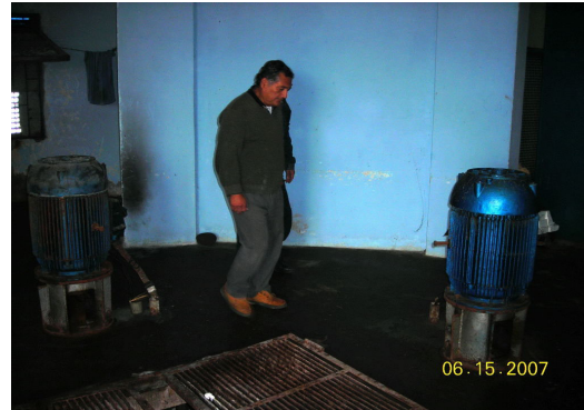
Vista N° 16.- Equipos de bombeo interior cámara de Bombeo Ica
