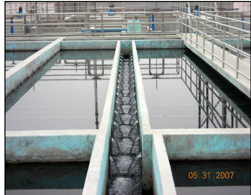
Vista N° 04.- Decantadores de Placas
