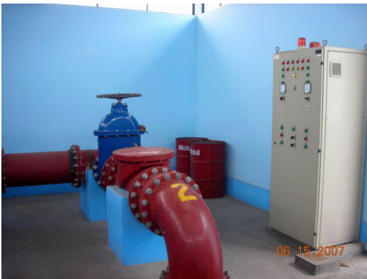
Vista N° 17.- Interior de la Cámara de Bombeo Villa María
