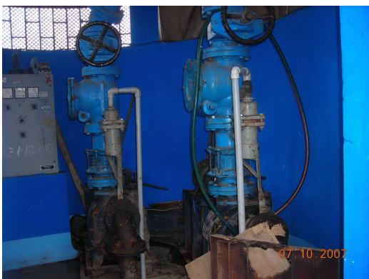
Vista N° 35. Instalaciones Hidráulica Cámara Pacaysito
