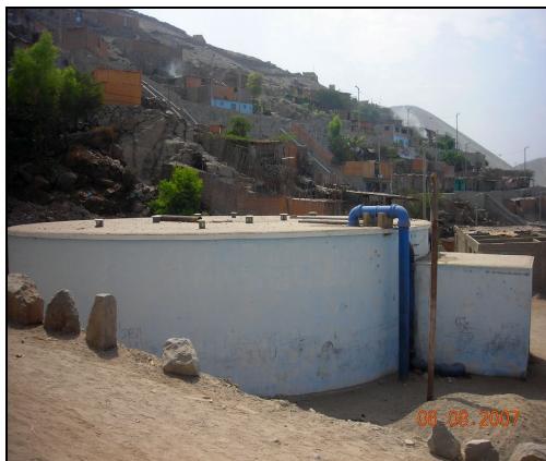
Vista N° 27. Reservorio R I 700 m 3 de Casma
