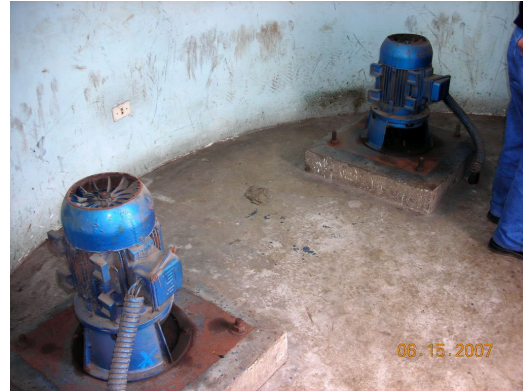
Vista N° 12.- Motores de 10 HP Cámara Trapecio
