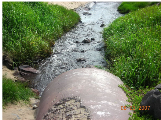
Vista N° 24.- Descarga de desagües industrial
