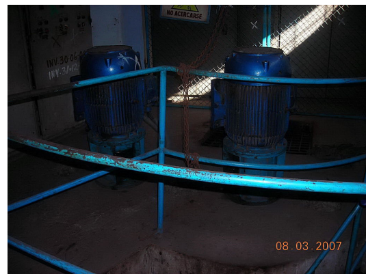
Vista N° 10.- Equipos de bombeo
