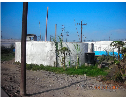
Vista N° 09.- Cámara de Bombeo de desagües San Pedro
