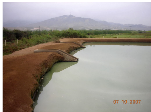
Vista N° 40. Taludes erosionados Laguna de Puerto Huarmey.
