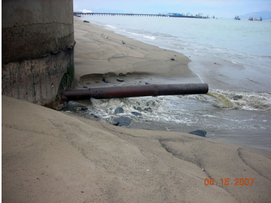
Vista N° 21.- Descarga de desagües Cámara de bombeo ICA
