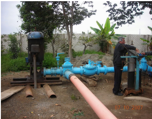
Vista N° 31. Pozo N° 1 A Huarmey
