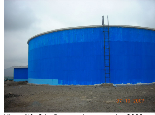
Vista N° 34. Reservorio apoyado 2000 m 3 Huarmey
