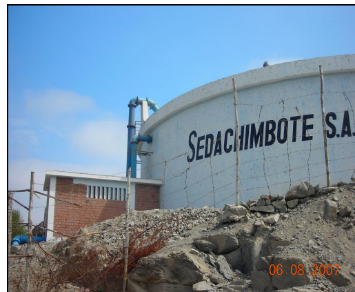
Vista N° 28.- Reservorio R II 2000 m 3 de Casma
