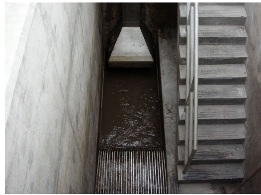
Vista N° 18.- Rejas ubicadas al ingreso de la cámara húmeda - Cámara de Bombeo Villa María.
